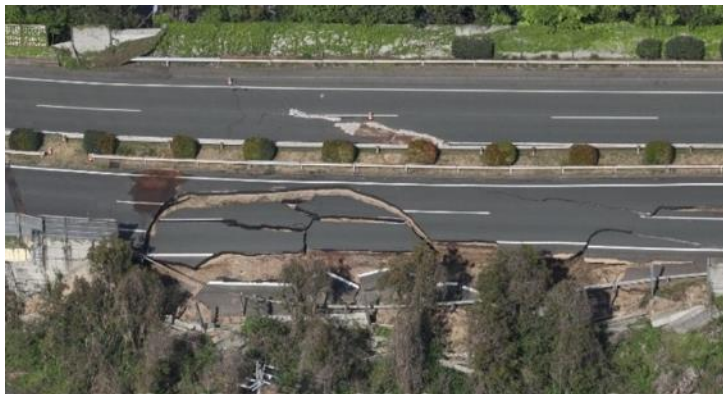
九州道の被災状況(益城バスストップ付近)
