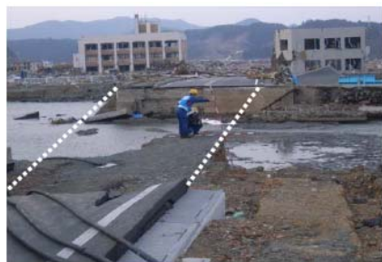
道路被災調査【国道45号】
