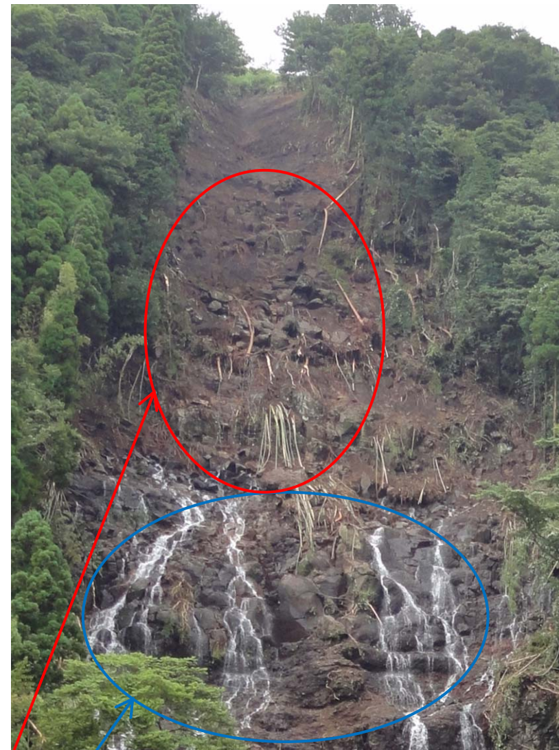
斜面からの流水 浮き石(直径約1~2mが無数に存在)
