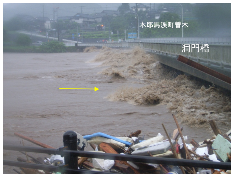
洞門橋上流の越水状況(7/14 8:40)
