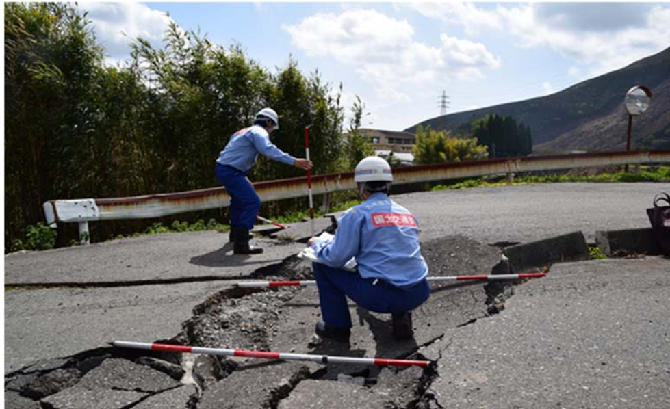
▲ 道路被災箇所を調査
