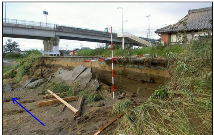
高潮による堤防崩れ状況(平成18年台風13号)
