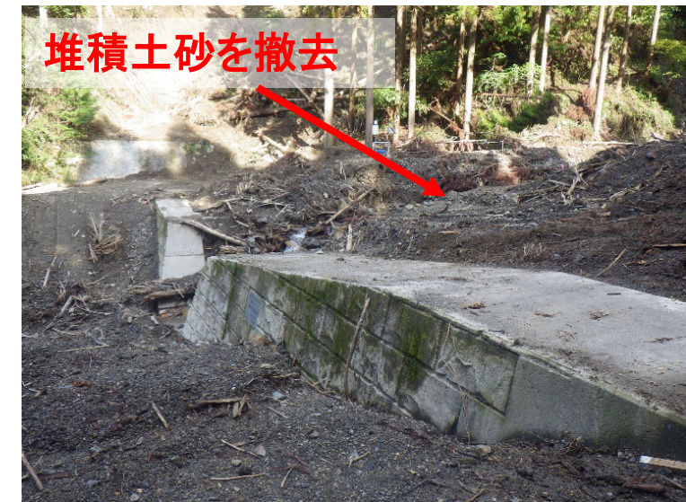
土砂の堆積状況 (汐井谷砂防堰堤)
