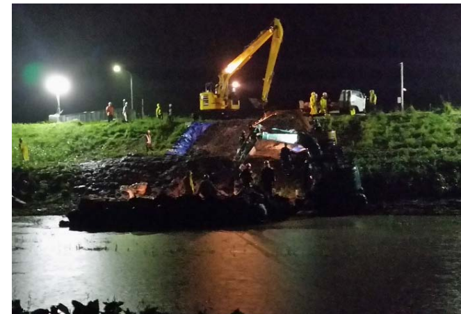
応急対策状況
