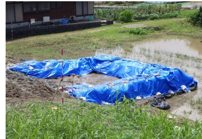
応急対策状況
