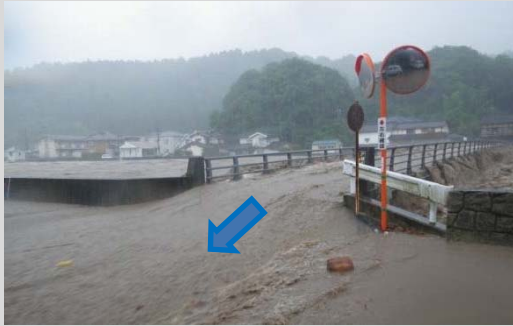
九州北部豪雨(2012.7.3)の夕田橋の状況
