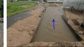
土砂堆積（東本川）
