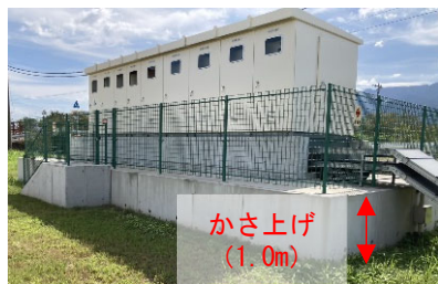
【第1受変電設備】
