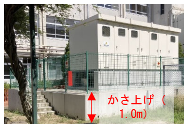
【第2受変電設備】
