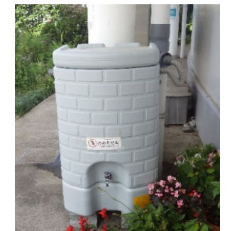
公共施設に設置した雨水貯留タンク
