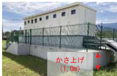
【第1受変電設備】
