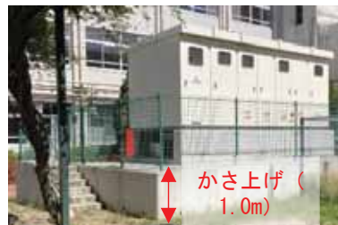
【第2受変電設備】
