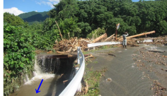
流木による河道閉塞 (冷水川)
