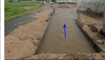
土砂堆積 (東本川)
