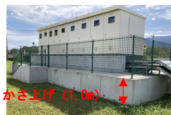
電気機器等の設置高所化事例
