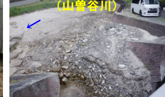
河道内の土砂堆積 (山笠谷川)
