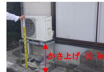
室外機の設置高所化事例
