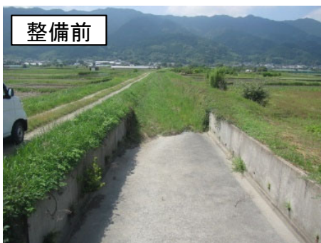
土砂堆積状況
