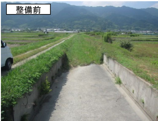
千ノ尾川 土砂堆積状況
