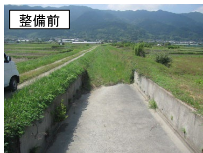
土砂堆積状況
