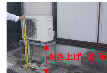
室外機の設置高所化事例
