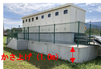
電気機器等の設置高所化事例
