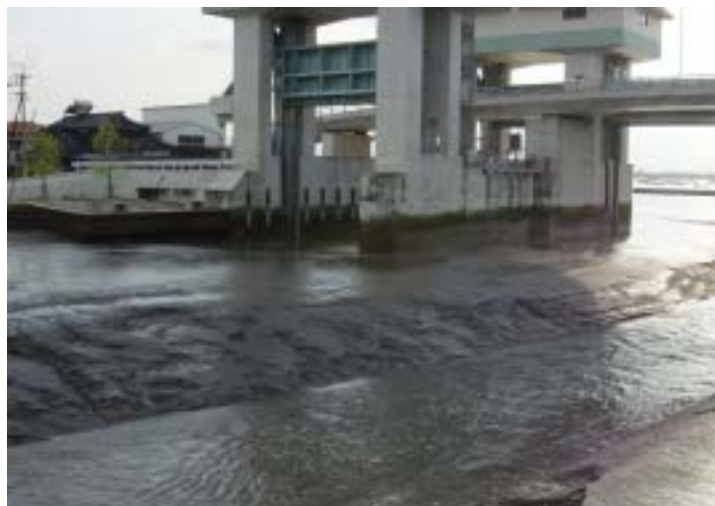
ガタ土の堆積 (花宗水門)
