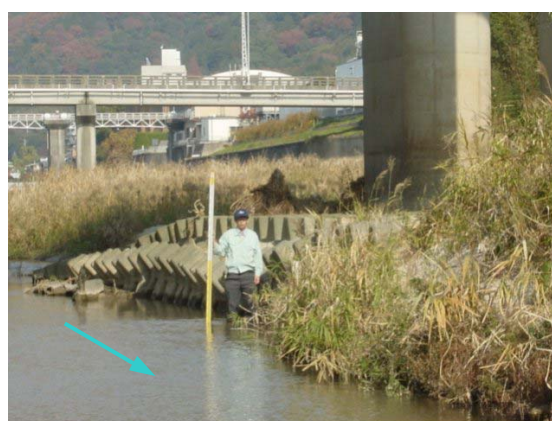
写真 2-1-5 河床低下状況（九州自動車道橋脚）
