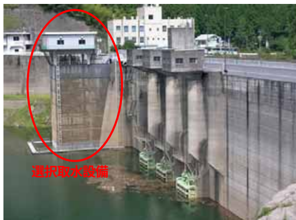
写真 4-2-8 松原ダムの選択取水設備
