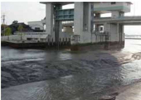
写真 4-3-7 ガタ土の堆積状況 (花宗水門)
