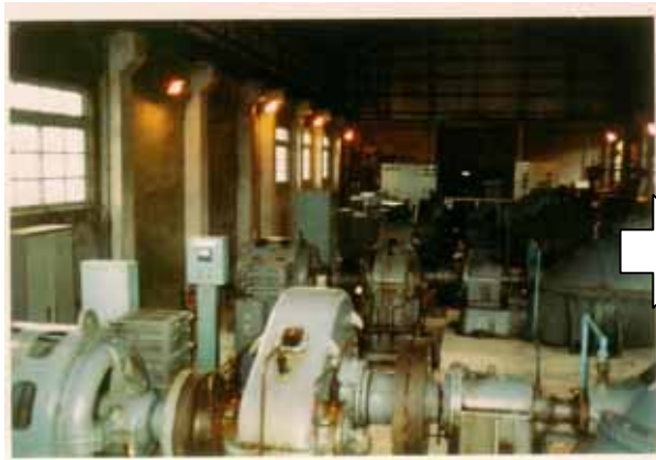
更新前 (排水機場)
