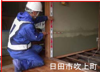
花月川右岸3k000 浸水状況(屋内)
