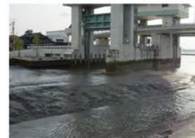
写真4-3-7 ガタ土の堆積状況 (花宗水門)
