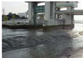
写真4-3-7 ガタ土の堆積状況 (花宗水門)
