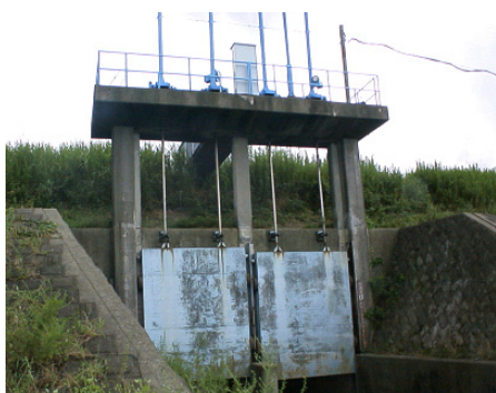
写真 2-1-22 老朽化した河川管理施設（樋門）
