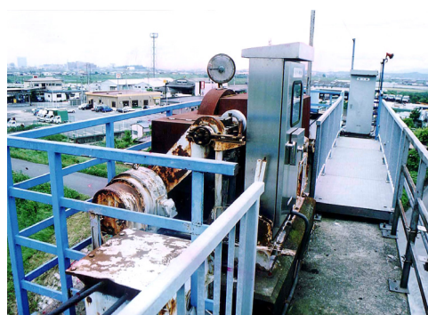
写真 2-1-23 老朽化した河川管理施設（開閉機）
