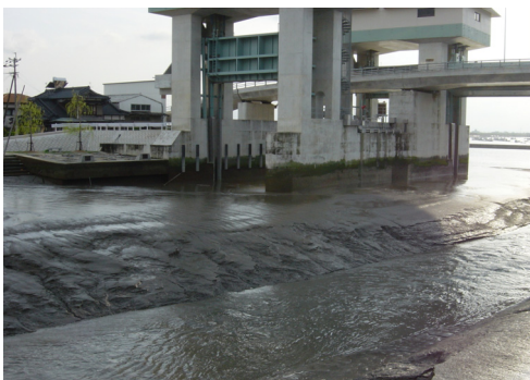
写真 4-3-7 ガタ土の堆積状況 (花宗水門)
