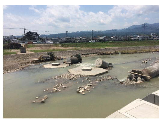
写真 1-2-28 倒壊した JR 鉄道橋 (日田市)
