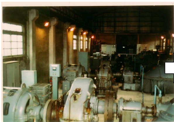
更新前（排水機場）
