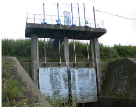
写真 2-1-2 2 老朽化した河川管理施設（樋門）
