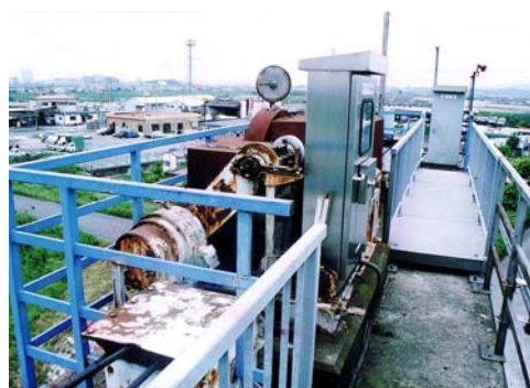
写真 2-1-2 3 老朽化した河川管理施設（開閉機）
