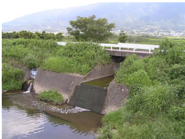
写真4-2-7 連続性が確保できていない水路（巨瀬川）
