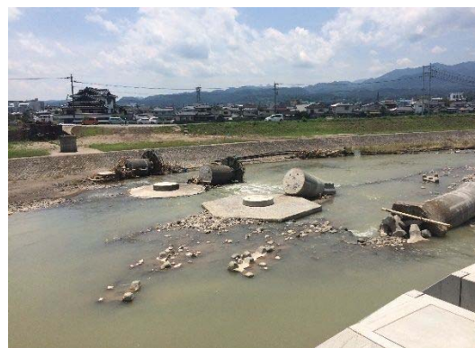
写真 1-2-28 倒壊した JR 鉄道橋 (日田市)
