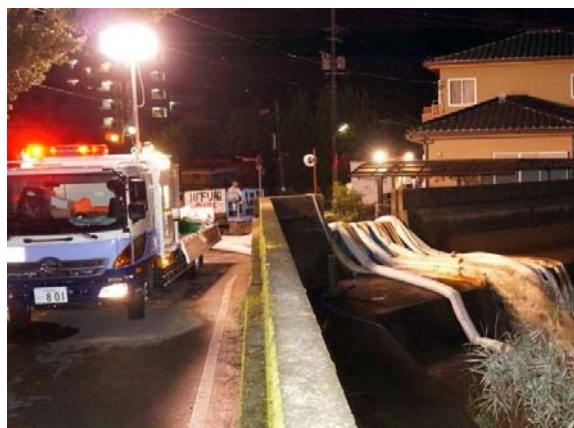
写真 2.1.8 排水ポンプ車 (福岡県柳川市)
