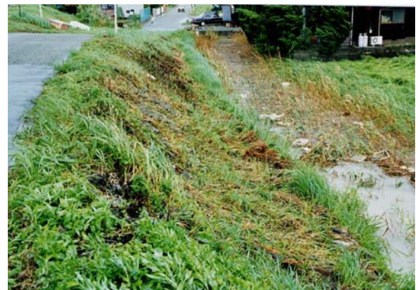
写真 2.1.6 平成 11 年楠田川高潮越波後状況 （みやま市高田町江浦地区）
