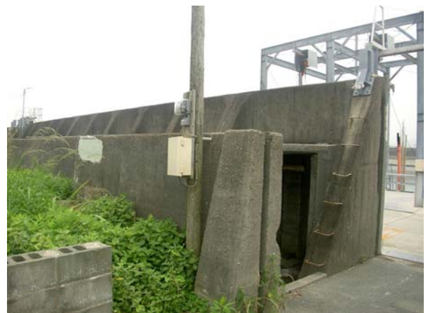
写真 2.1.4 老朽化した特殊堤（川裏） （柳川市中島地区）
