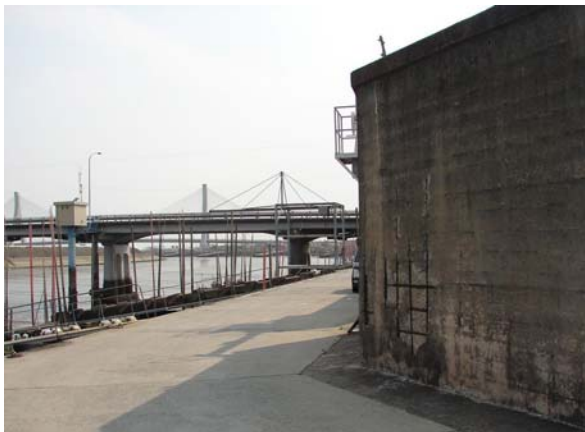
写真 2.1.3 老朽化した特殊堤（川表） （柳川市中島地区）
