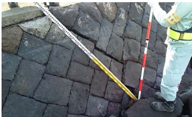
写真 2.1.12 老朽化した堤防護岸
