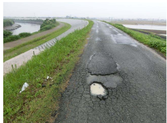
写真 2.1.13 堤防天端の不陸による水溜まり
