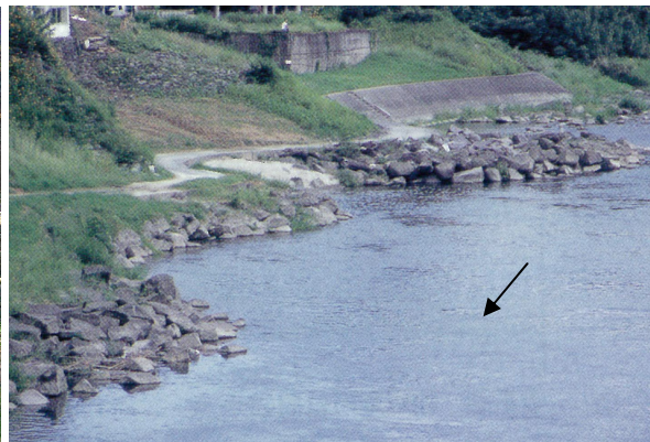
写真 5.2.2 筑後川における水剝 (朝倉市 筑後川右岸 59k600 付近)
