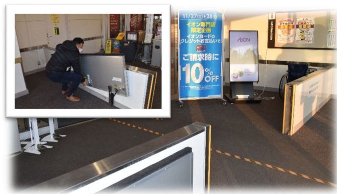
館内入口の止水設備
