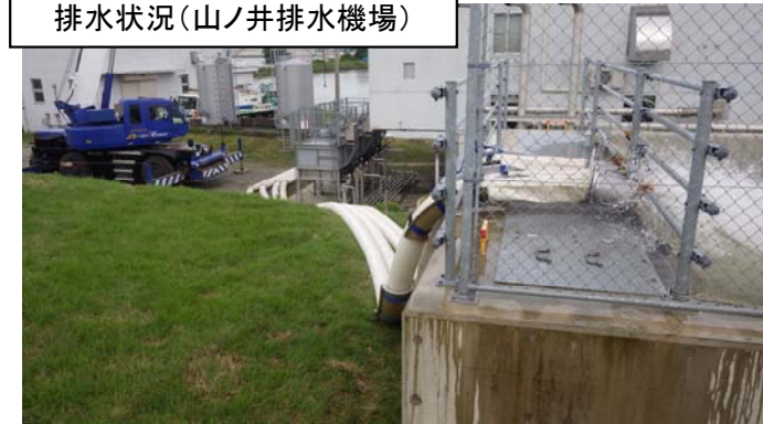
排水状況（旧陣屋川樋管）
