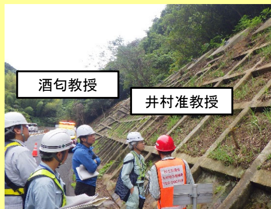
現地診断状況(切土)
