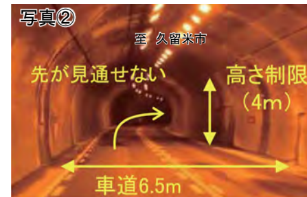
▲高さ制限と視距不足の状況
