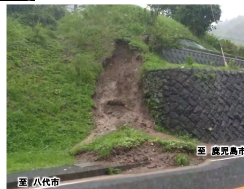
▲ 法面崩壊状況 (R3.7)
