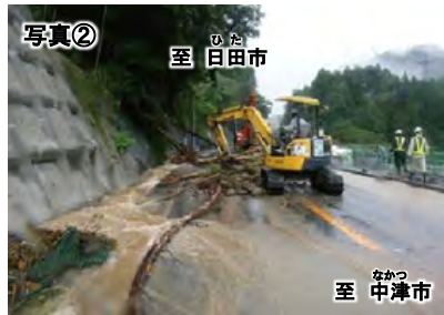
▲ 風水害による土砂流出状況
