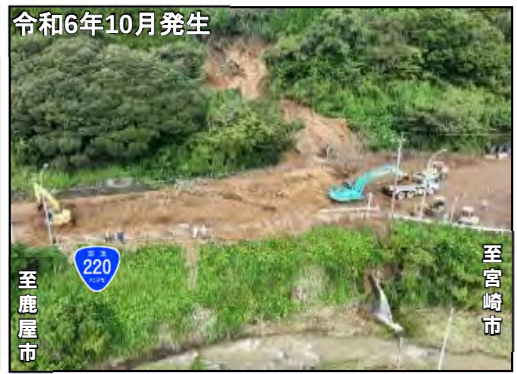
【写真②】大雨時の法面崩壊(串間市)
