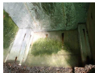
上部工の損傷状況
