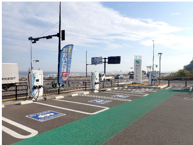
▲「道の駅」におけるEV充電器の設置
