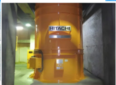
換気設備（送風機）
