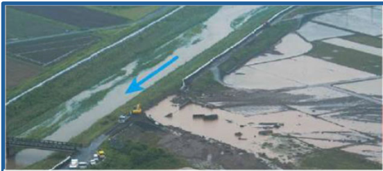
平成28年熊本地震で堤防が沈下。 大型土のうによる応急復旧後、6月 の大雨により堤防決壊（益城町）
