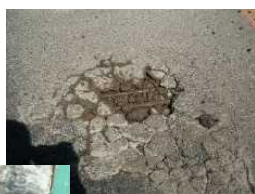
(床版上面) 舗装土砂化
