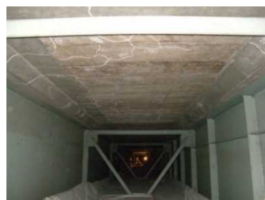
ひび割れの発生
