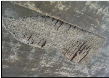
▲ 損傷状況(剥離・鉄筋露出)
