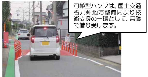
可搬型設置イメージ(福岡県新宮町)
