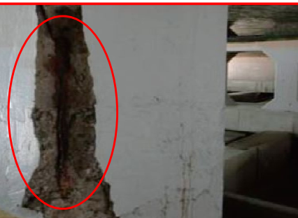
▲ 春吉橋の損傷状況(架替前)
