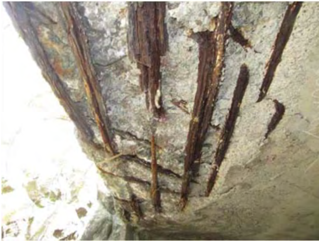
国管理 床版鉄筋露出 ※床版: 橋の裏側
