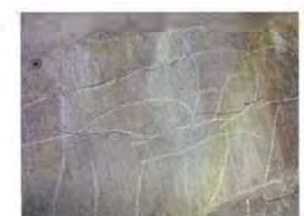
下部工のひび割れ
