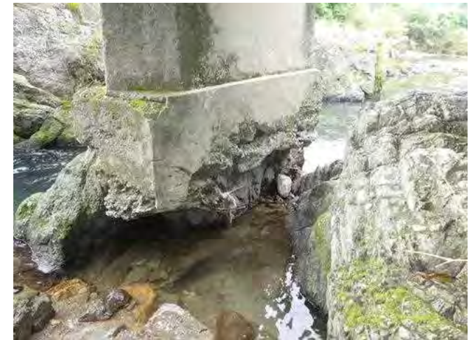
地方自治体管理 橋脚洗掘
