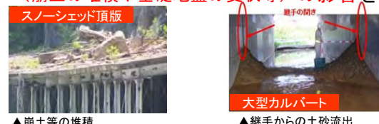
▲崩土等の堆積
