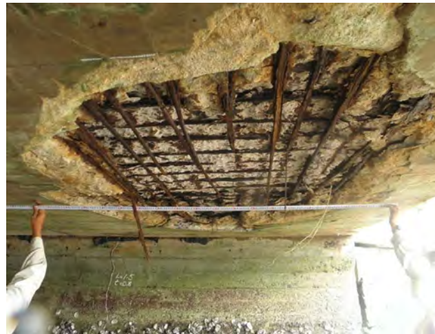
地方自治体管理 床版鉄筋露出
