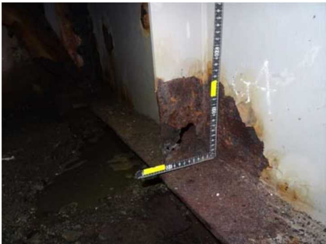
国管理 主桁腐食・欠損
