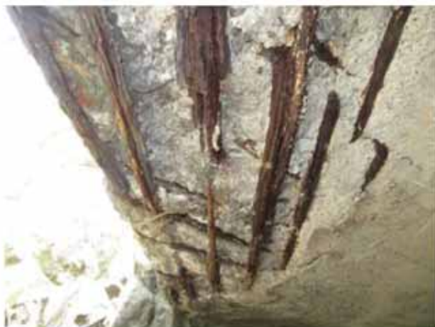
国管理 床版鉄筋露出 ※床版:橋の裏側
