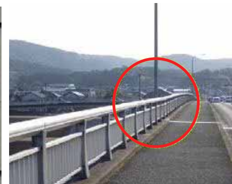
▲中央ヒンジ部の垂れ下がり
