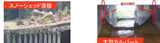
▲崩土等の堆積 ▲継手からの土砂流出
