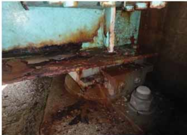
地方自治体管理 主桁腐食
