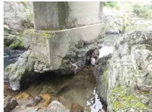
地方自治体管理 橋脚洗掘
