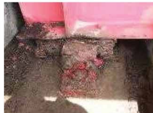
地方自治体管理 支承腐食
