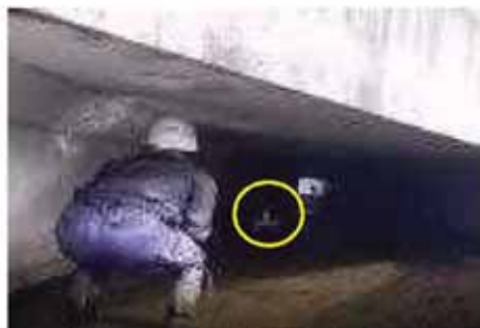
水面から動画撮影を実施し損傷状況を把握
