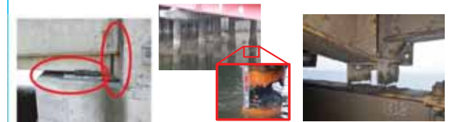
▲桁端部や支承まわりの狭あい部 ▲杭の水中部（腐食・断面欠損の例） ▲シェッド頂部の主梁端部（破断の例）
