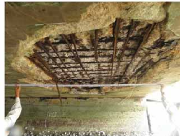
地方自治体管理 床版鉄筋露出
