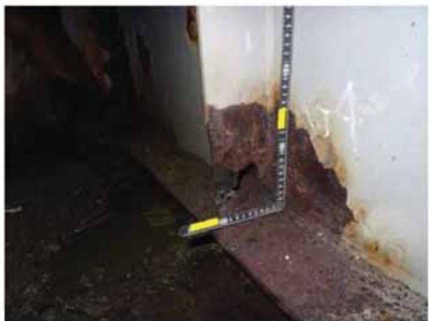
国管理 主桁腐食・欠損
