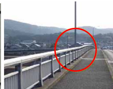
▲中央ヒンジ部の垂れ下がり
