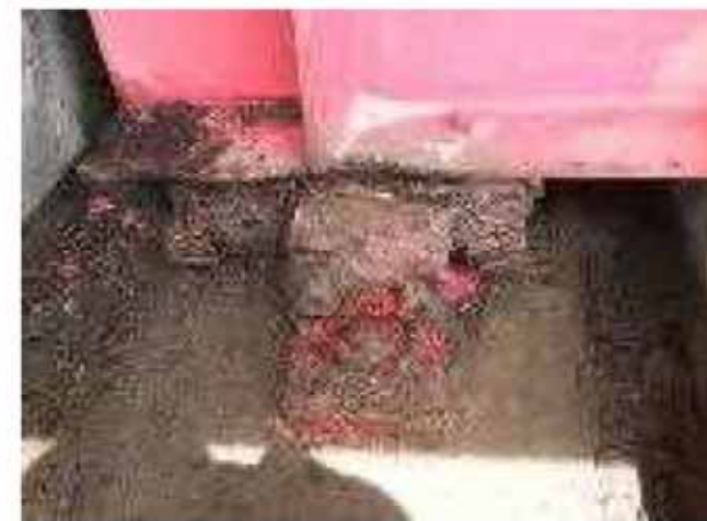
地方自治体管理 支承腐食
