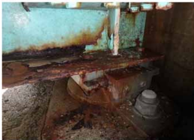
地方自治体管理 主桁腐食
