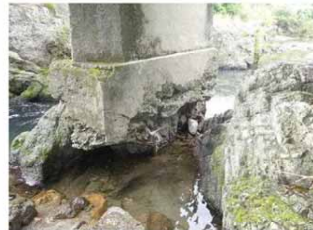
地方自治体管理 橋脚洗掘
