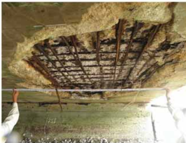
地方自治体管理 床版鉄筋露出
