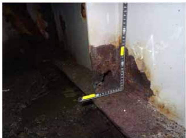
国管理 主桁腐食・欠損
