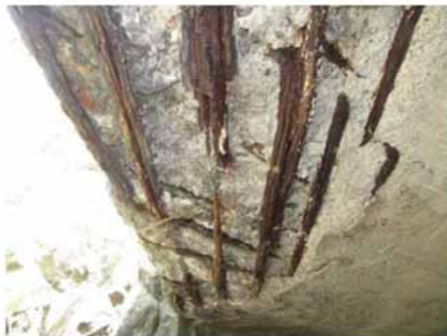
国管理 床版鉄筋露出
