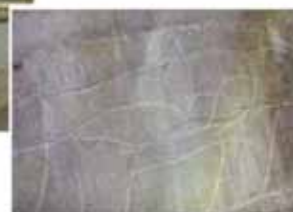
下部工のひび割れ
