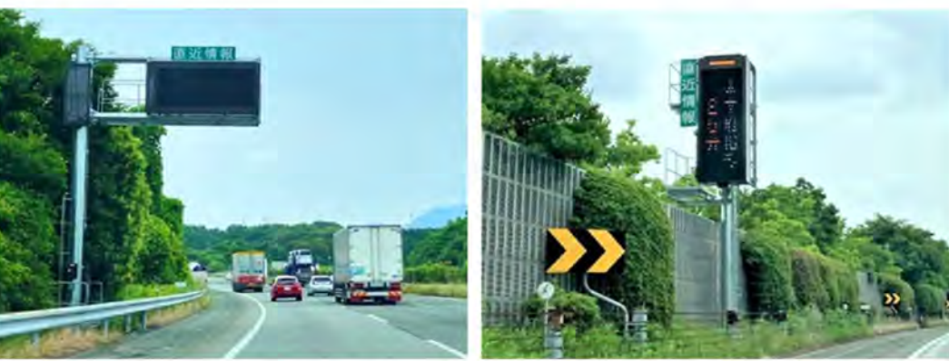
●路側情報板 3車線用（横型）、2車線用（縦形）
