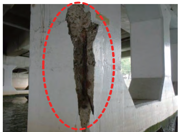
▲ 春吉橋の損傷状況: コンクリート剥離・鉄筋露出
