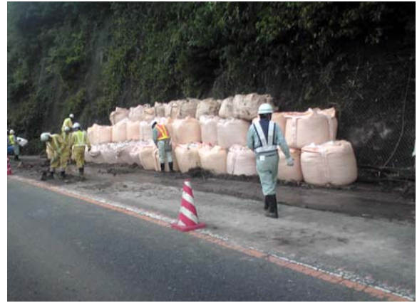
平成24年7月14日発生災害 国道210号(うきは市)
