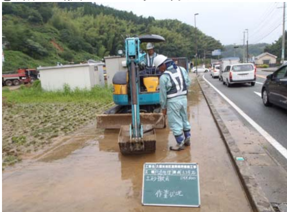
平成24年7月14日発生災害 国道3号(八女市)
