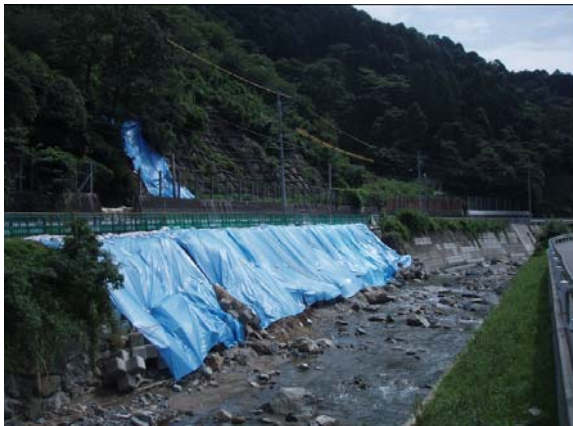
平成21年7月24日発生災害 国道201号(糟屋郡篠栗町)
