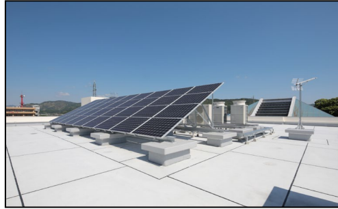
延岡労働総合庁舎 （太陽光発電設備） 【令和4年度完成】
