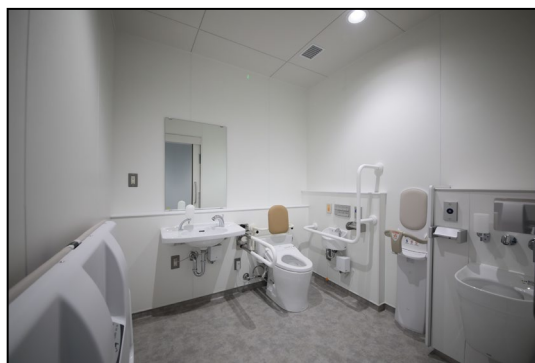
延岡労働総合庁舎 （多機能便所） 【令和4年度完成】
