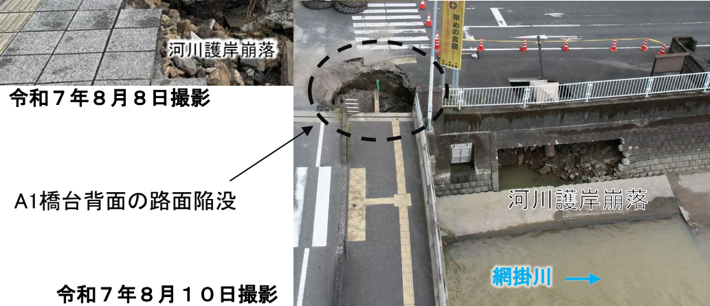
写真③ 【下流側護岸の被災状況】
