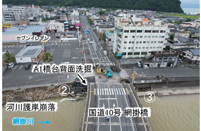
写真② 【上流側護岸の被災状況】
