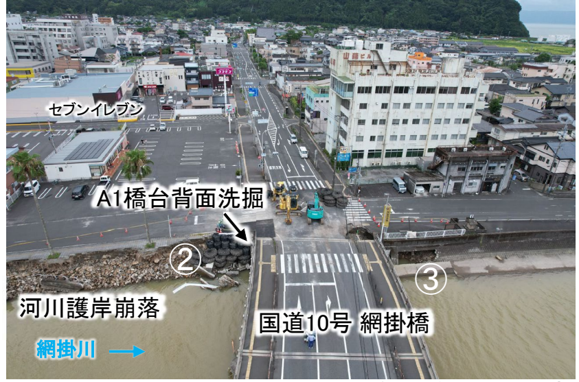
写真② 【上流側護岸の被災状況】 令和7年8月10日撮影
