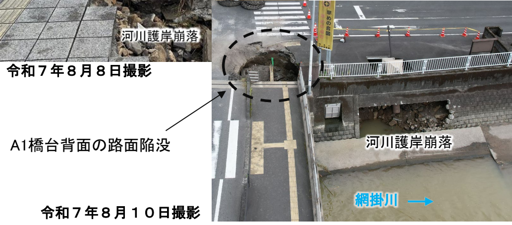
写真③ 【下流側護岸の被災状況】
