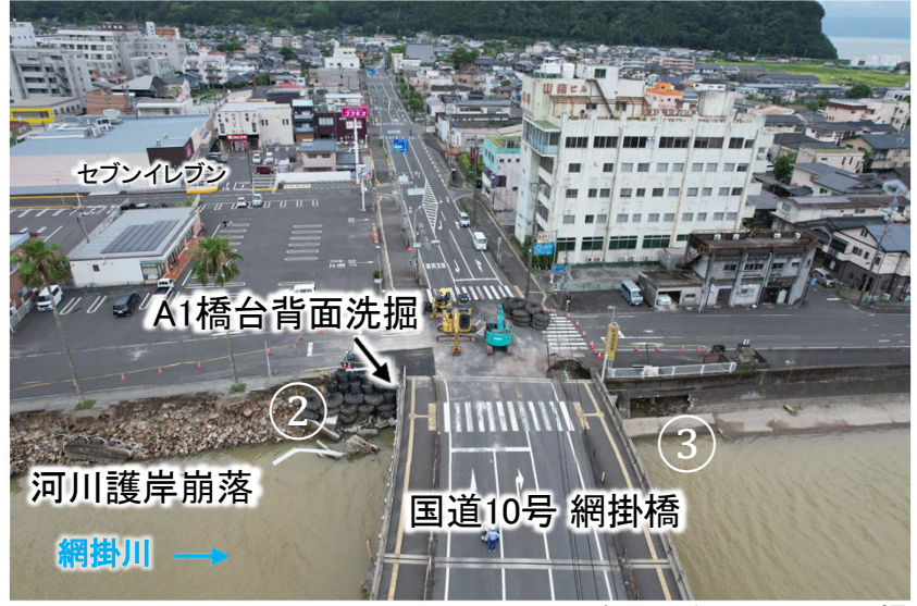
写真①【被災状況】
