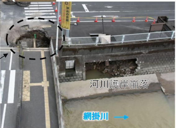
写真③ 【下流側護岸の被災状況】
