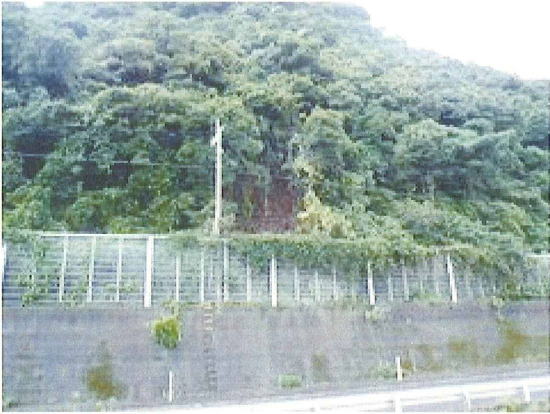
被災状況写真(452K090)
